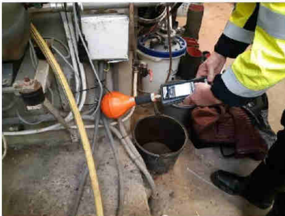
Foto 1: Meting van de magnetische veldsterkte bij de voedingskabel van de technische ruimte.
