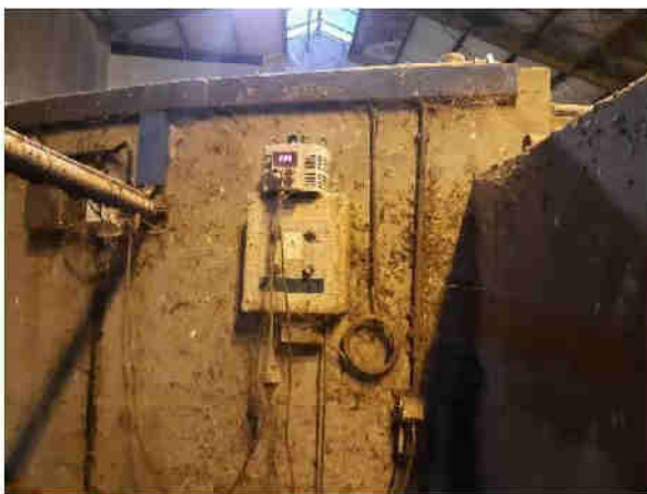
Foto 2: Het koe-herkenningssysteem met daarop een regeltransformator.
