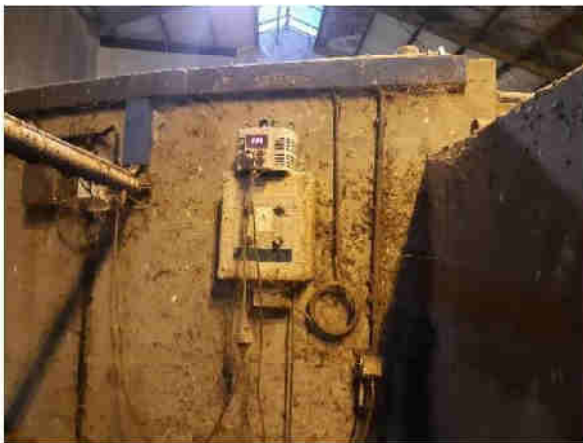
Foto 2: Het koe-herkenningssysteem met daarop een regeltransformator.
