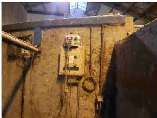
Regeltransformator voor koeherkenningssysteem
