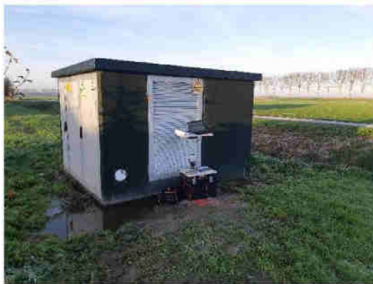
Foto transformator bedrijf A
