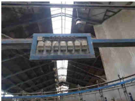
4 Voeding met transformatoren
