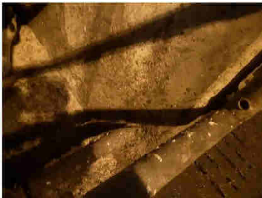
Verbinding tussen waterbak en ligbox
