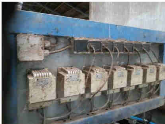
6 Voedingen met transformatoren
