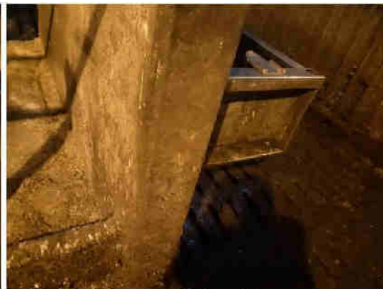
Verbinding tussen waterbak en ligbox
