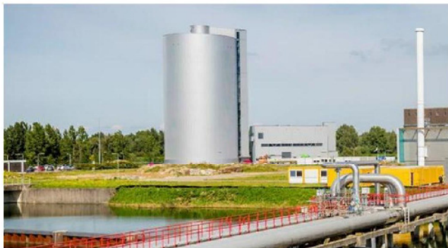
Afbeelding 1.12 Bovengrondse warmteopslagtank Diemen
