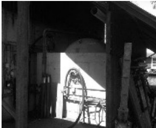
Bovengrondse tank met zoutoplossing
