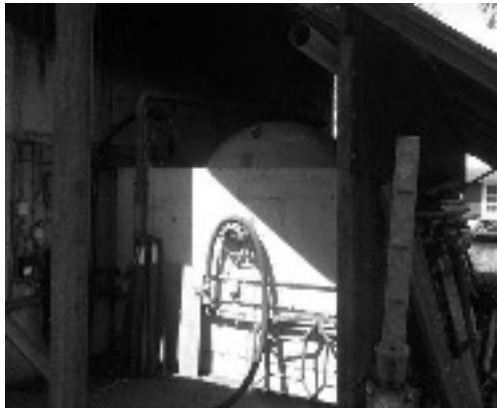
Bovengrondse tank met zoutoplossing
