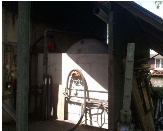
Bovengrondse tank met zoutoplossing
