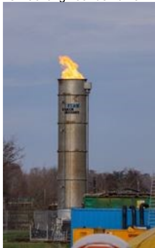
Door middel van "affakkelen" wordt resterend gas uit de oude leidingen verwijderd. Foto: KJfotografie
