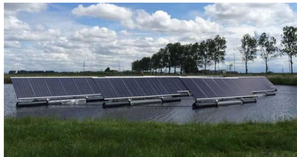
Drijvende zonnepanelen (Rijkswaterstaat, Slufter)
