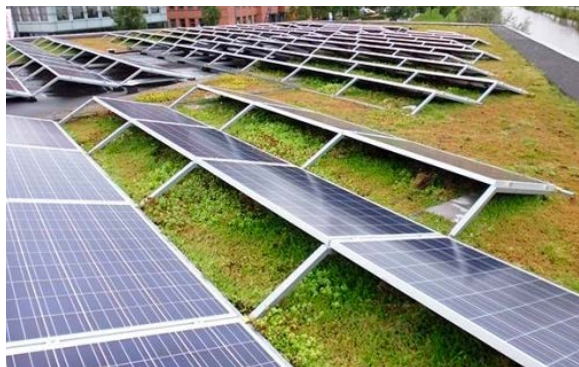
Zonnepanelen in combinatie met groene daken
