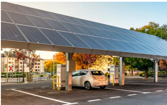
Zonnepanelen in combinatie met parkeren
