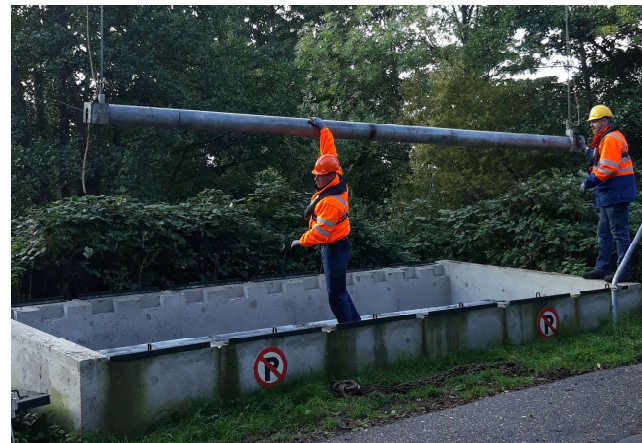
Huidige schotbalkopslag waaruit een schotbalk wordt gehesen
