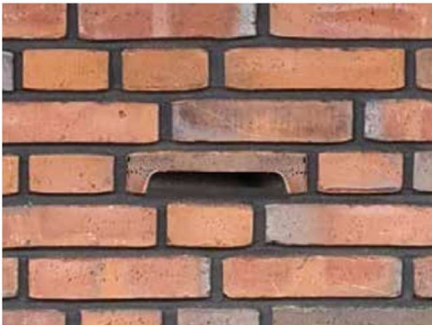
FIGUUR 13 – OPENING VLEERMUISKAST IIRK
