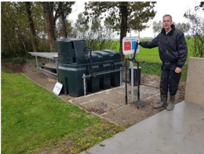
Wasplaats met zuiveringssysteem en tweewegklep
