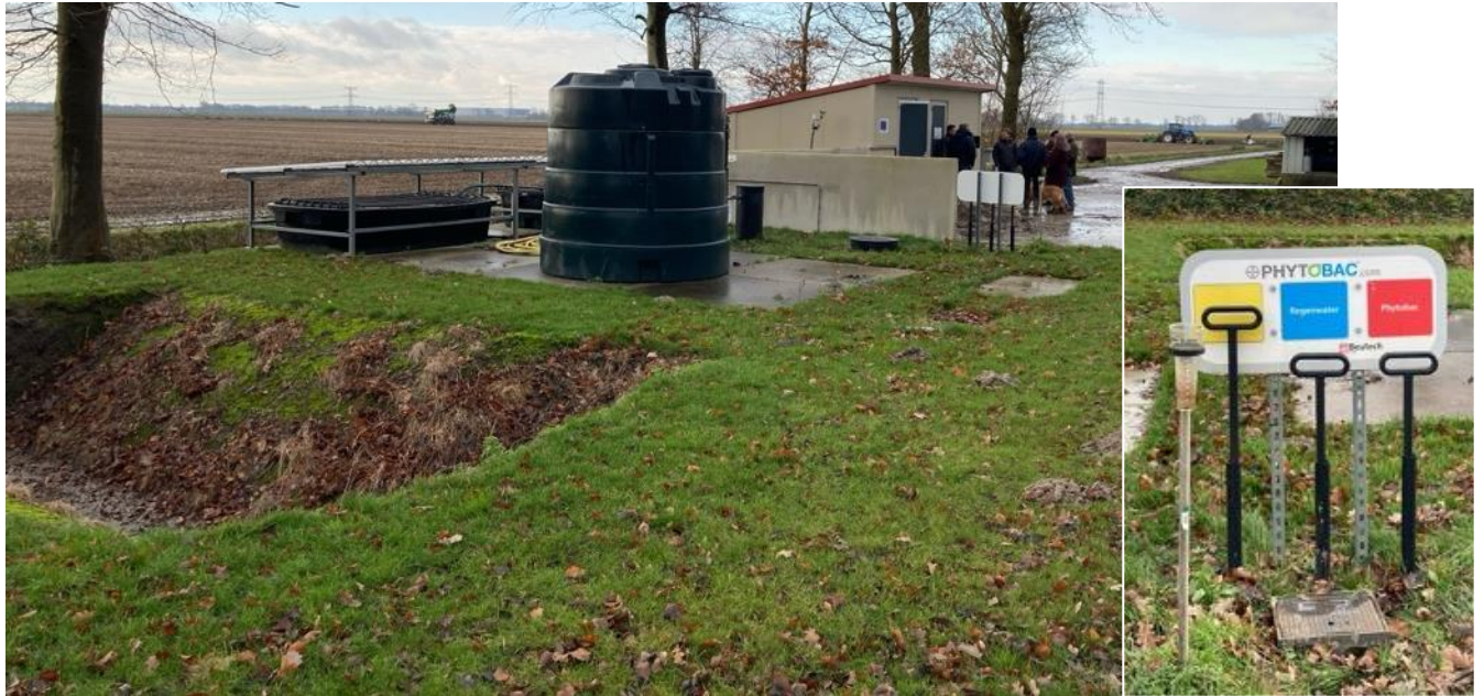
Figuur 4.9 Niet overdekte combi-wasplaats met driewegklep (zie inzet): - Waswater met gbm wordt gezuiverd met een Phytobac. - Waswater zonder gbm gaat door een slibvangput en olieafscheider en infiltreert in een infiltratievoorziening (linksonder op de foto). - Hemelwater van de schone wasplaats gaat rechtstreeks naar de infiltratievoorziening.
