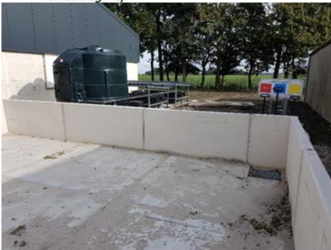
Wasplaats met zuiveringssysteem en driewegklep
