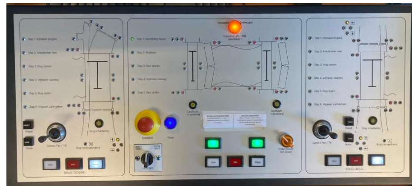
Figuur 11. Bedienpaneel bruggen en sluis JS 1 (opbouw is gelijk aan JS 2)
